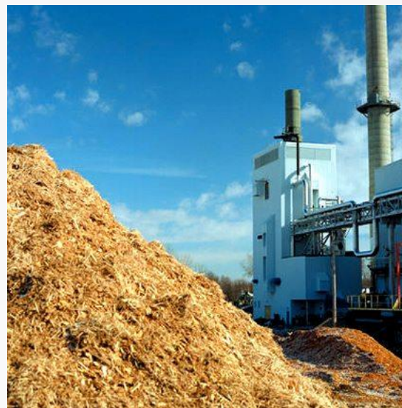
Caldaia a biomassa alimentata a cippato
