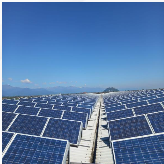
Fotovoltaico che permette l'autonomia energetica di impianti ed uffici
